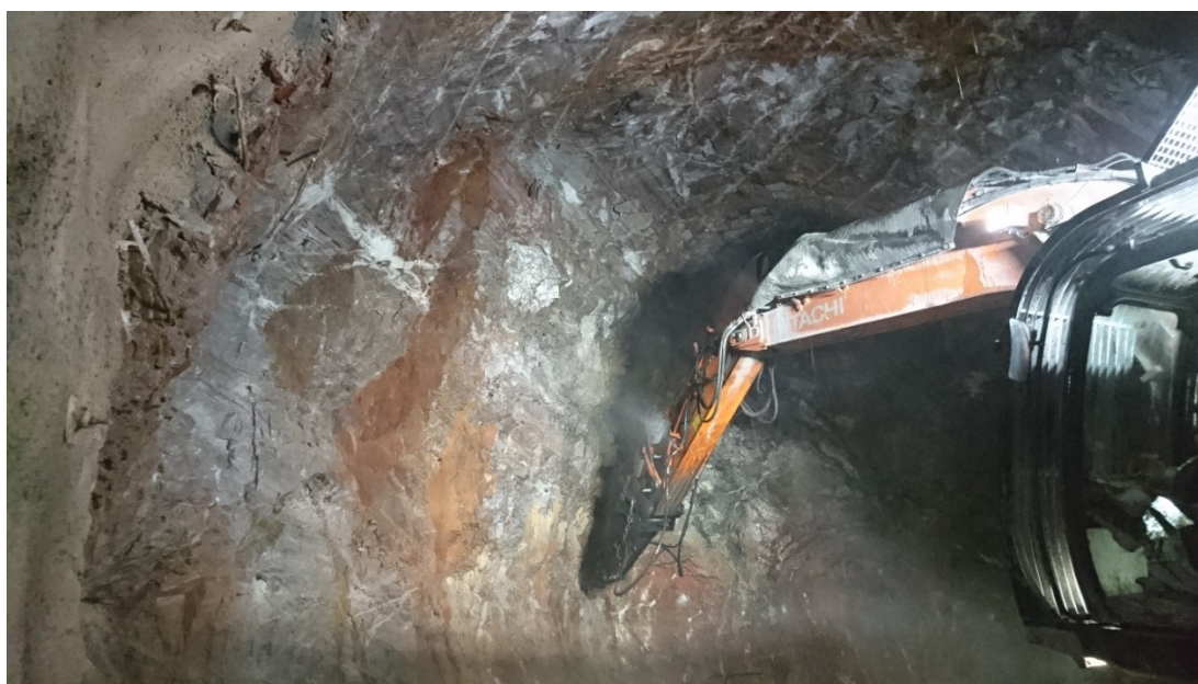
Figur 8 Tynne sprekker i kvartsitten med leiraktig belegg
