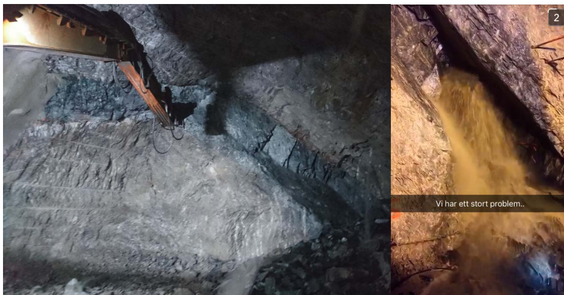
Figur 14 Pigging etter opprettingsalve ved pel nr. 13292 til venstre. Lekkasje fra gabbrogang til høyre
