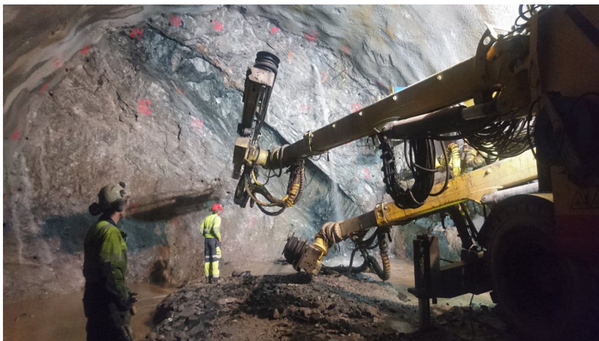
Figur 16 Mye lekkasje i avlastningshull på høyre side
