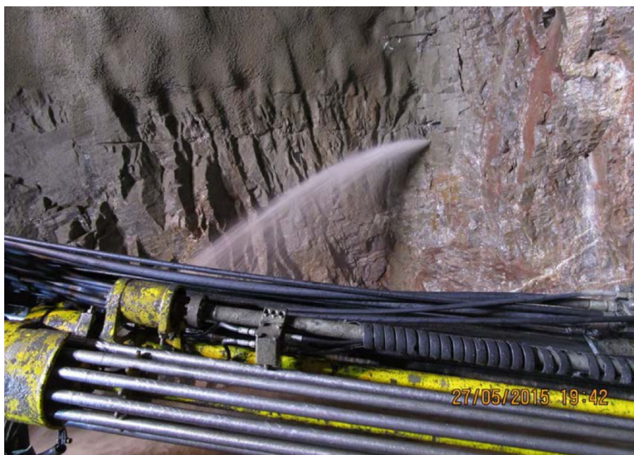
Figur 11 Eksempel på innlekkasje påtruffet ved pel nr. 14914
