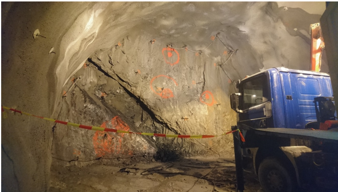
Figur 13 Utfall av forvitret bergmasse fra gabbrogang pel nr. 13297 (13. mai)
