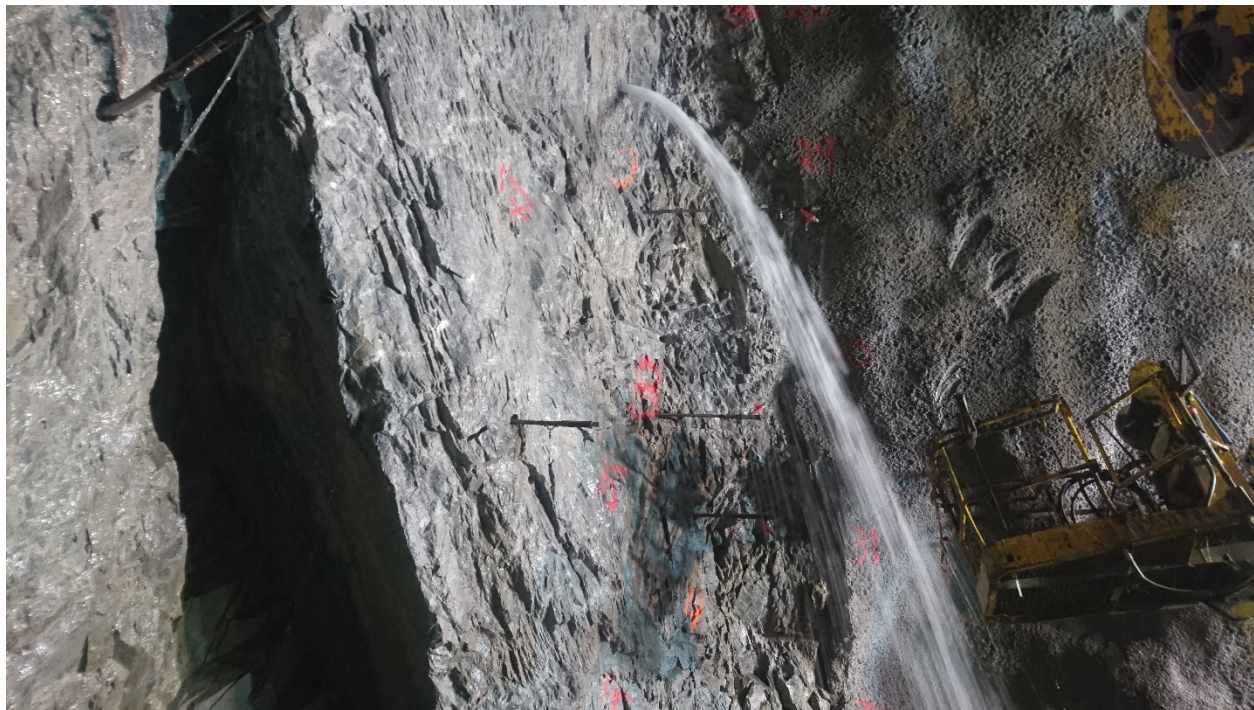
Figur 17 Hull i stoffen ved pel nr. 13292 som ble spruta inn (21. mai)
